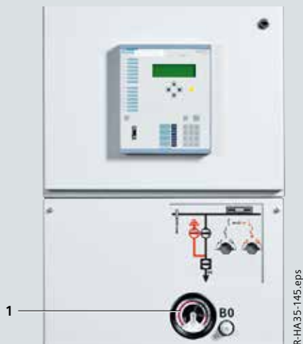
断路器气压表（1） 位于柜体前部
