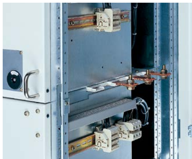
位于正面的电缆连接隔室
