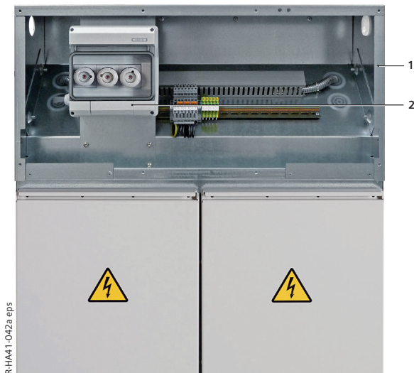
计量柜 M 柜的低压小室，室门打开
